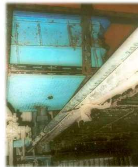
AR設置済み給水タンク
