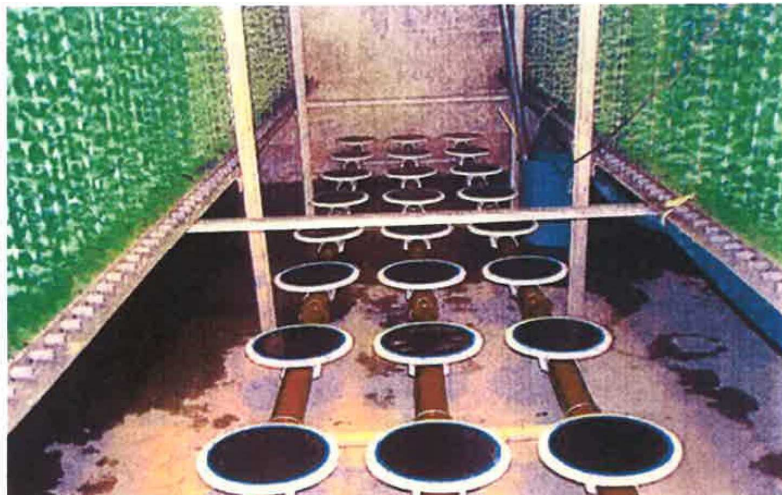
・沈殿槽(SMS法改良後)
