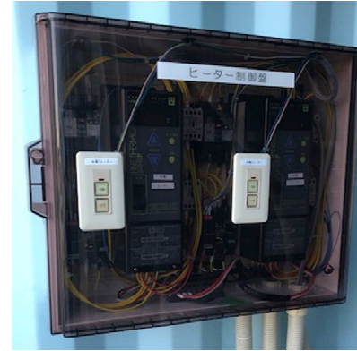
曝気槽ヒーター制御盤
