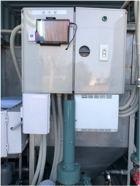
IOT操作監視盤
