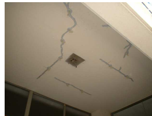
天井・建造物ひび割れ部分
